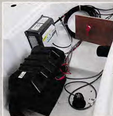
▲ La batterie Stormline dans son bac, son coupe-circuit et le chargeur Cristec Ypower. Et un grand merci à l'ami Gérard R. pour l'installation...
