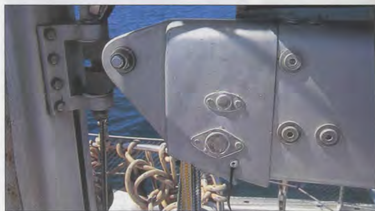
Sur ce vit-de-mulet, les rivets ont lâché un par un. Tous les trous ont été reperçés, taraudés et boulonnés.
