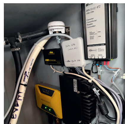
derrière tableau électrique
