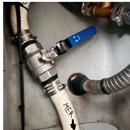
équipée à droite de la cuvette des toilettes
