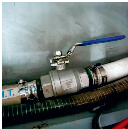
sous le lavabo, sur le réservoir d'eau
