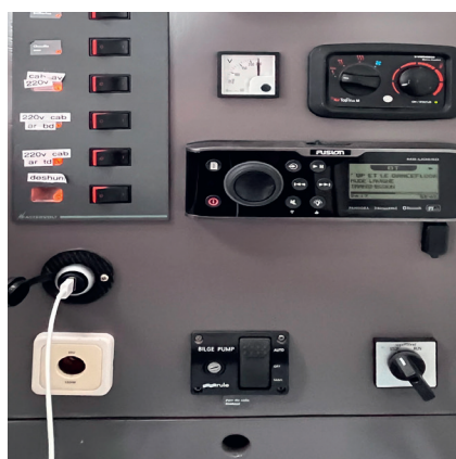
bas du tableau électrique
